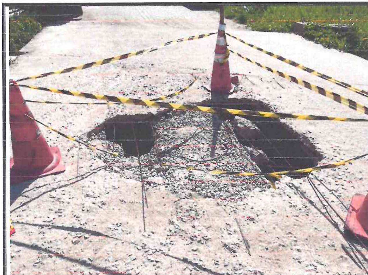
FOTO 03 – PATOLOGIA ENCONTRADA NO PONTILHÃO DA RUA JUAREZ TÁVORA
