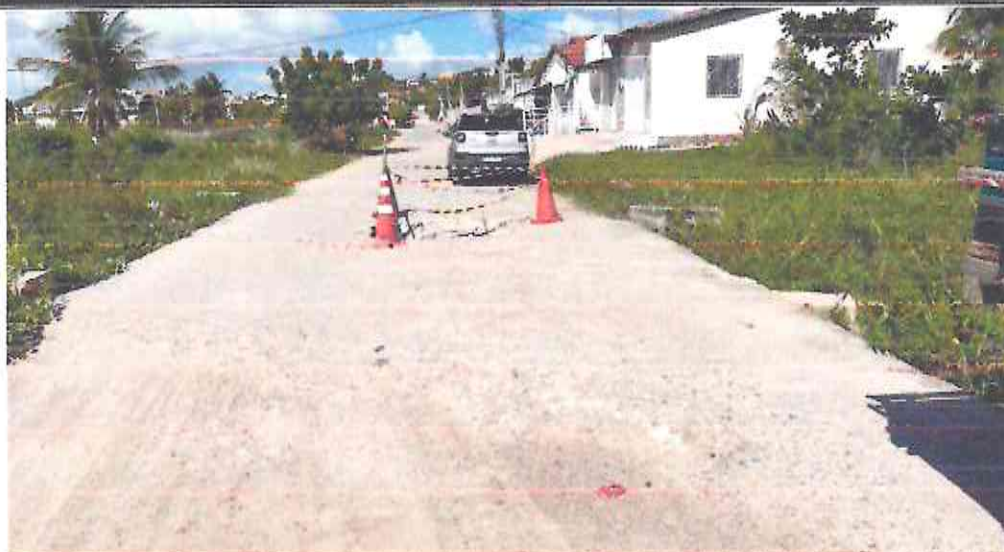
FOTO 02 – PONTILHÃO COMPROMETIDO DA RUA JUAREZ TÁVORA
