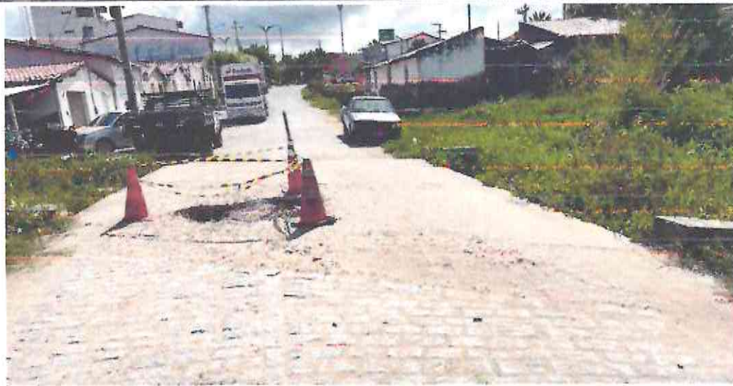
FOTO 01 – PONTILHÃO COMPROMETIDO DA RUA JUAREZ TÁVORA
