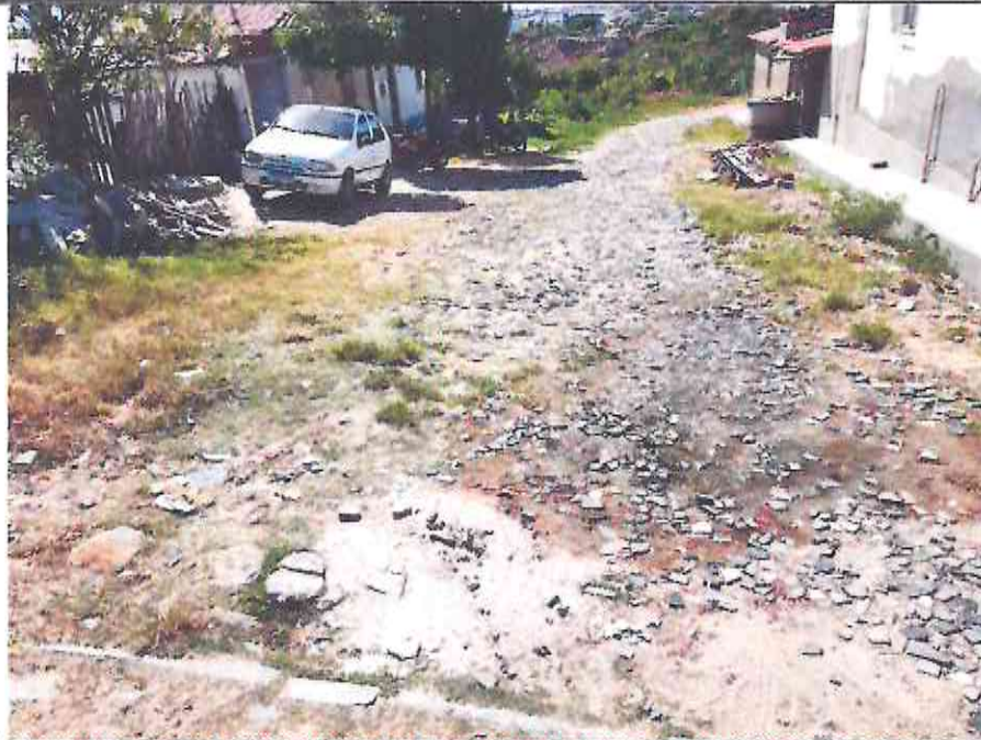
Início (Estaca E00) da RUA CAPITÃO JOSÉ RUFINO (TRECHO II) (Bairro: SÃO JOSÉ) (Coordenada UTM 568647.11 / 9435985.35)
