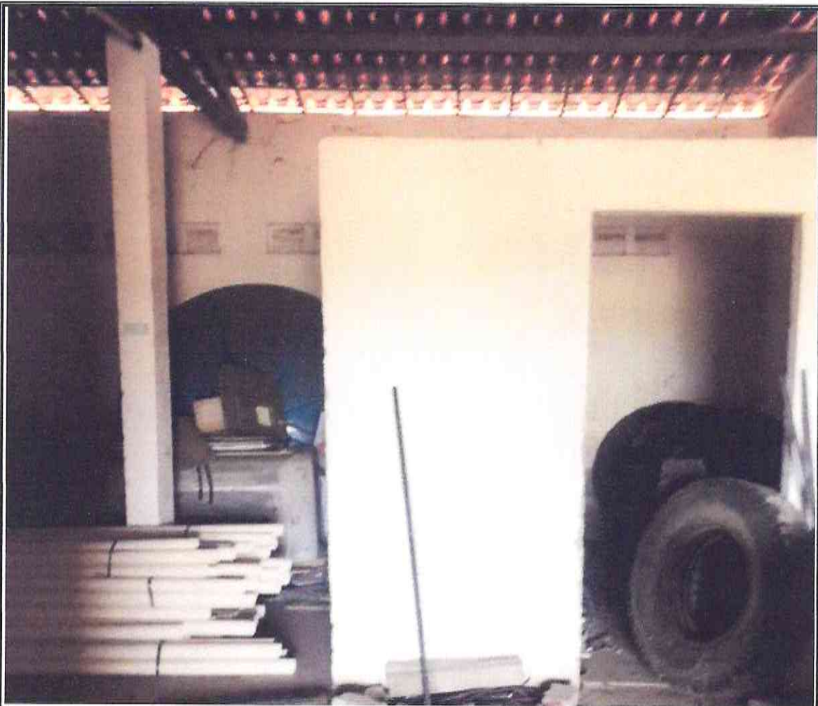
Figura 02- Escritório presente no prédio destinado ao Almojarifado da prefeitura de Morada Nova-CE
