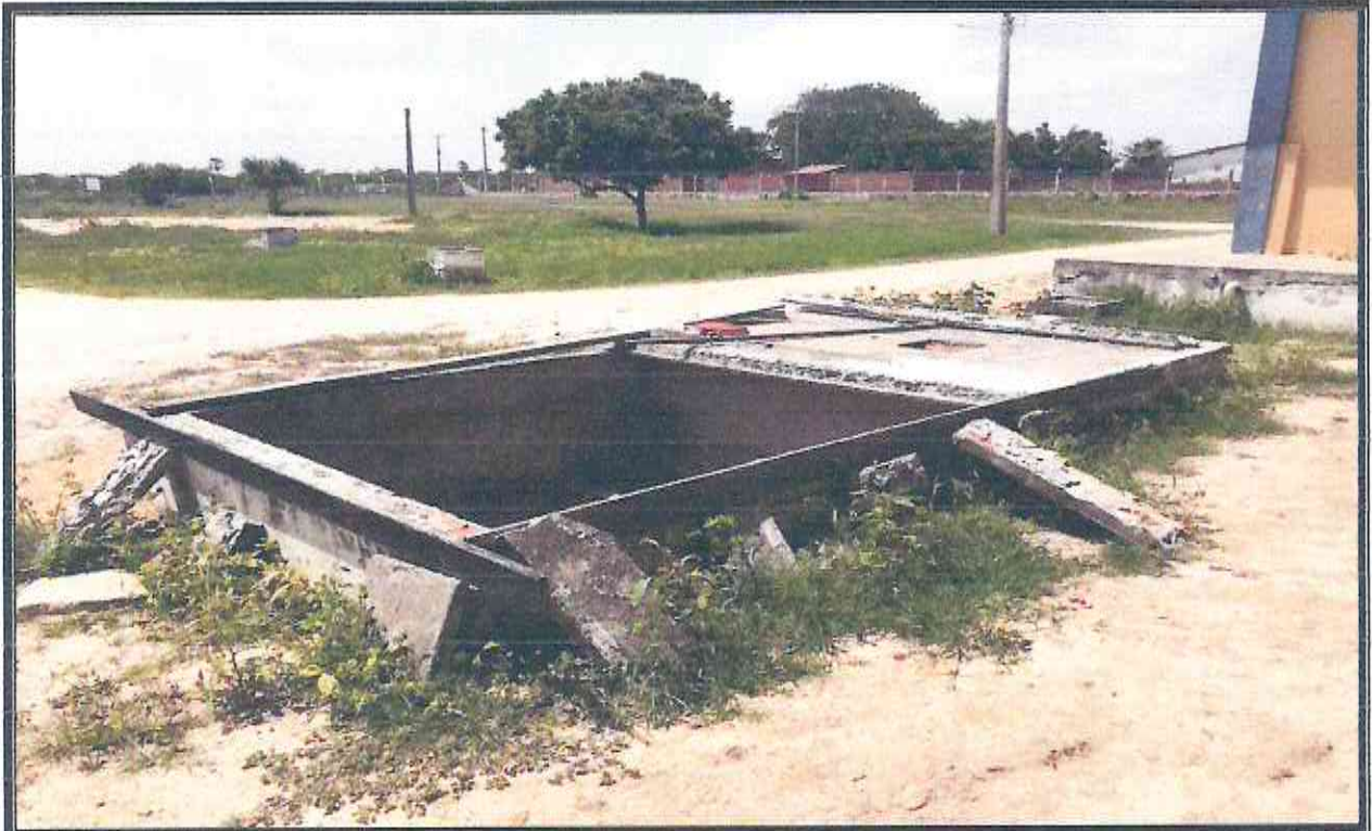
Figura 09- Sumidouro a ser inativado
