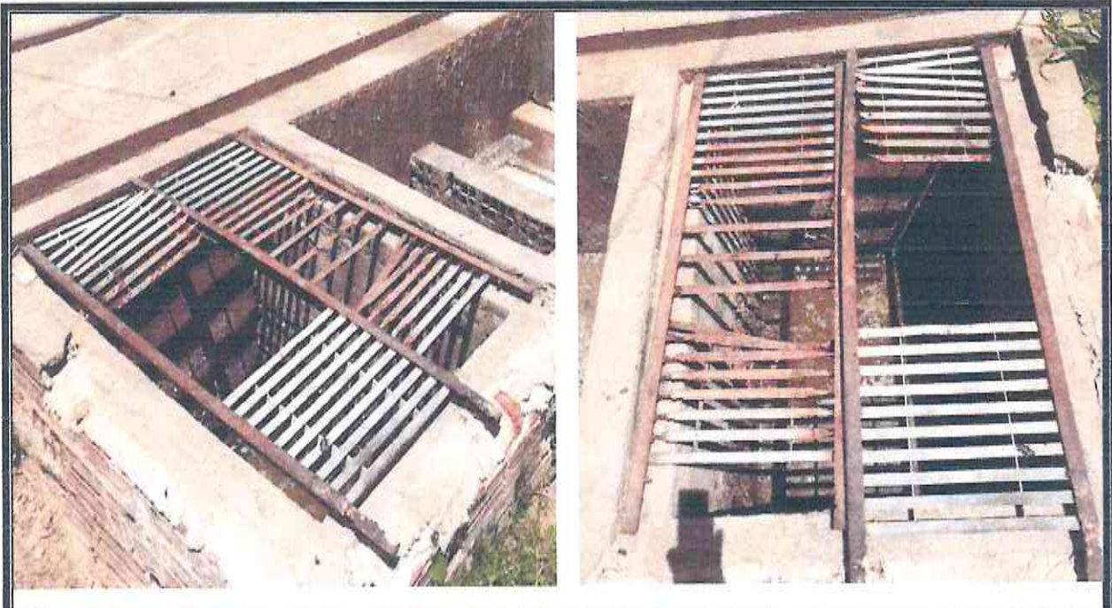
Figura 07- Telas de proteção do tanque de tratamento
