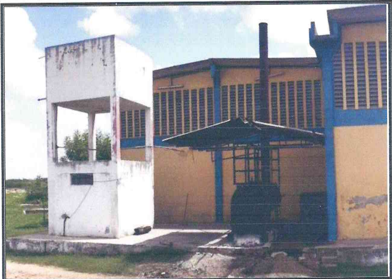
Figura 05- Caixa de água e caldeira do abatedouro de Morada Nova- CE
