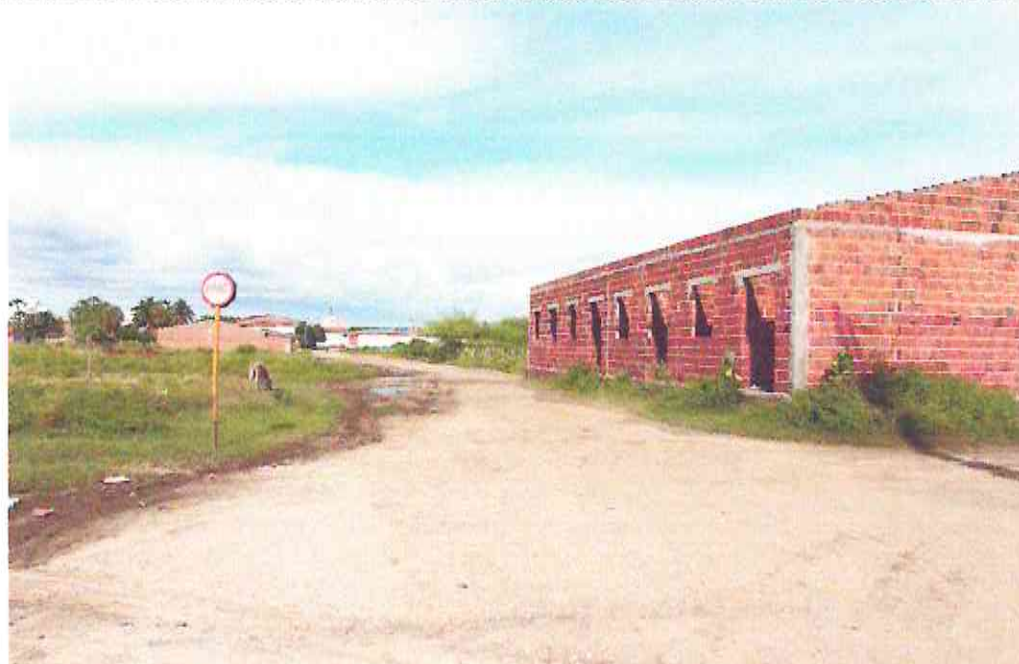
Final (Estaca E14) da Rua José Lourenço Filho (Bairro: Padre Assis Monteiro) UTM 569069.00 /9435255.00
